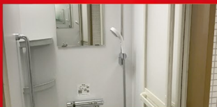
個室型シャワー男性8台・女性10台
